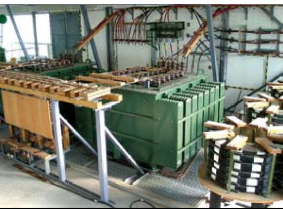
1. kép 2 db 10,4/0,173...1,04kV zárlati transzformátor
